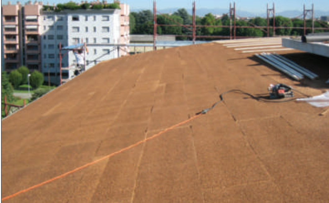
Copertura bioedile in legno. Sull'assito in legno posa ulteriore di strato separatore KoSep.C, pannelli in sughero biondo superkompatto SoKoVerd.LV a grana fine 2/3mm su cui verrà ricavata l'orditura in legno per la ventilazione della copertura sovrastante. Edificio residenziale bioedile in Classe A+ Monza- MI. Progetto AB3 Architettura Battistoni Associati Monza.
