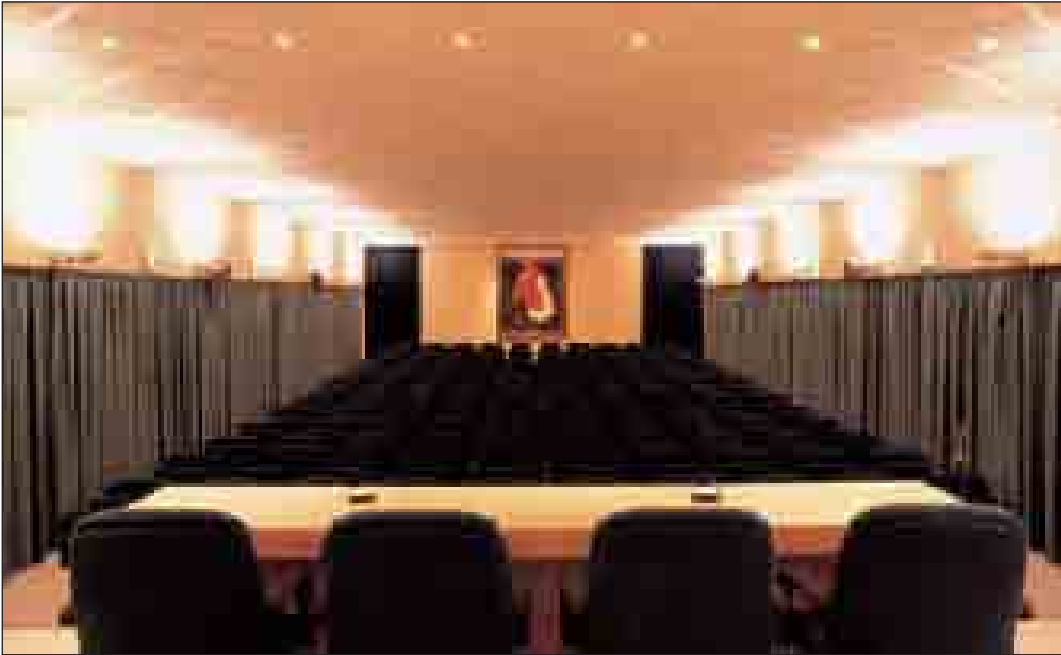
Auditorium - Particolare del controsoffitto realizzato con pannelli di sughero Kontro posati in diagonale
