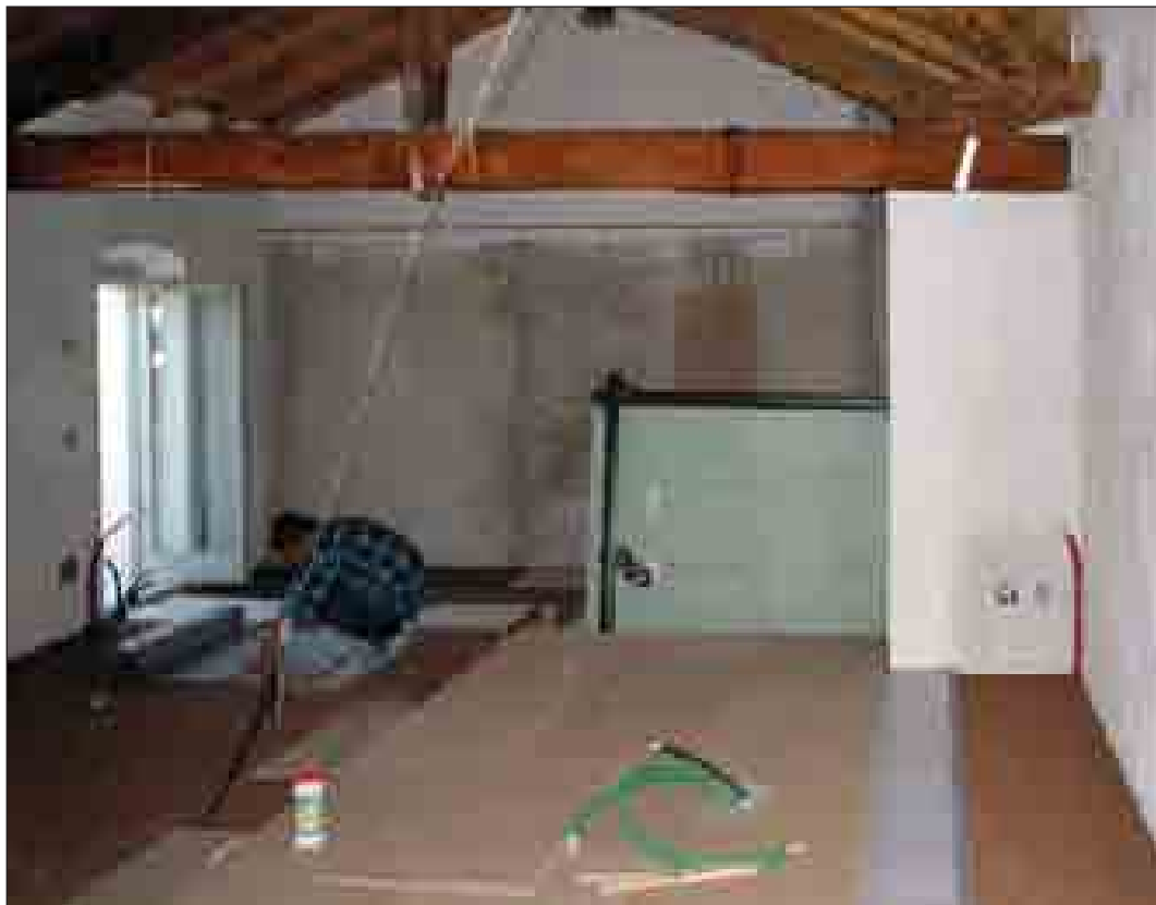
Particolare sottofondo leggero con impasto di sughero biondo naturale bollito e ventilato Sugherolite con vetrificante a presa aerea Koglass, strato separatore anticalpestio KoSep.F e pannelli di legno idrofugo KoSial.
