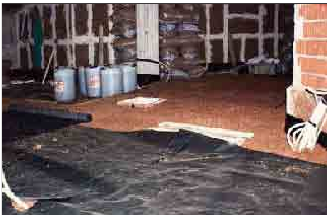
Esempio di completamento dell'isolamento termo-igrometrico delle pareti laterali mediante un cappotto interno con pannelli di sughero biondo naturale supercompatto SoKoVerd.LV e del solaio mediante un sottofondo con un impasto di granuli in sughero biondo naturale bollito e ventilato Sugherolite agglomerato con un legante vetrificante a presa aerea Koglass.
