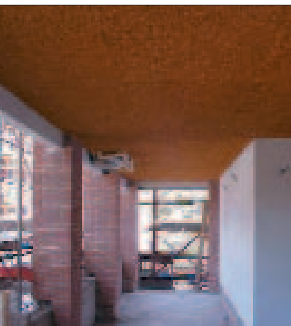
Esecuzione cappotto esterno del portico con pannelli in sughero biondo naturale compresso SoKoVerd.AF
