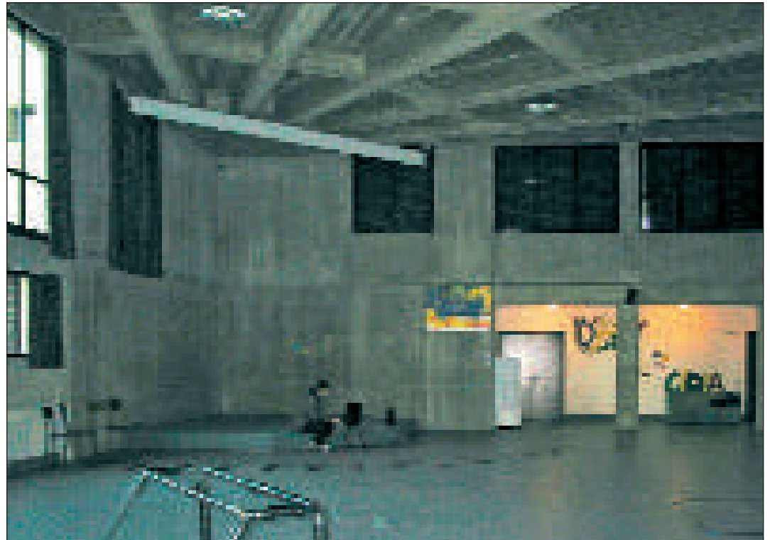
Parrocchia Dio Trinità d'Amore Vimodrone – MI Foto prima dell'intervento di bonifica acustica
