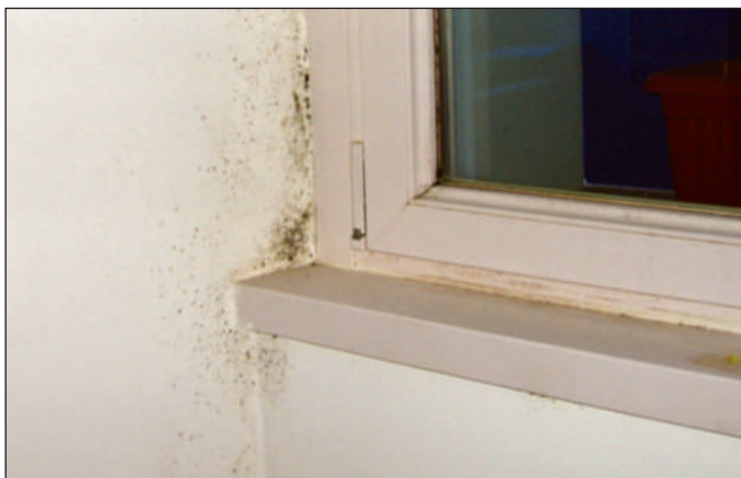
Esempio di ponte termico morfologico in prossimità del contorno telaio finestra.
