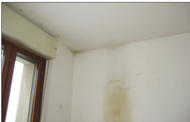
Esempio di ponte termico strutturale in corrispondenza del pilastro e della trave.
