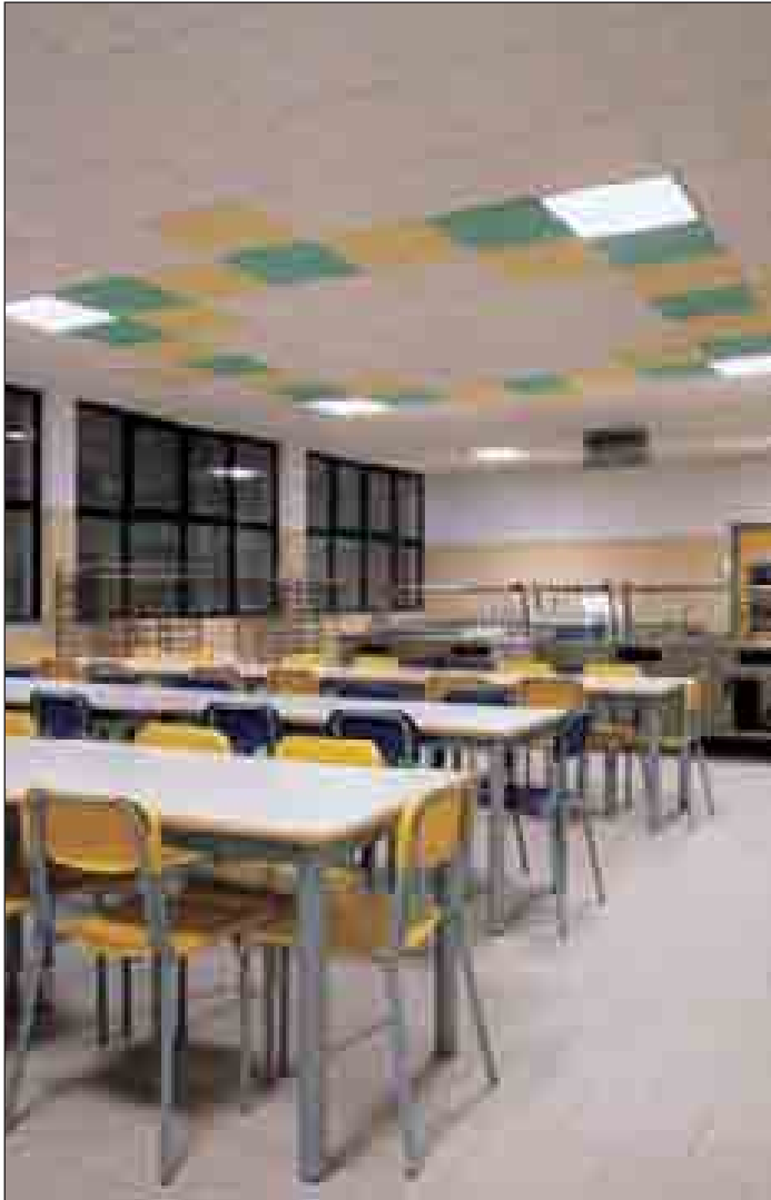
Mensa di Lesmo (MI) - Controsoffitto realizzato con pannelli in sughero Kontro a quadrotti gialli e verdi per rendere l'ambiente accogliente e vivace
