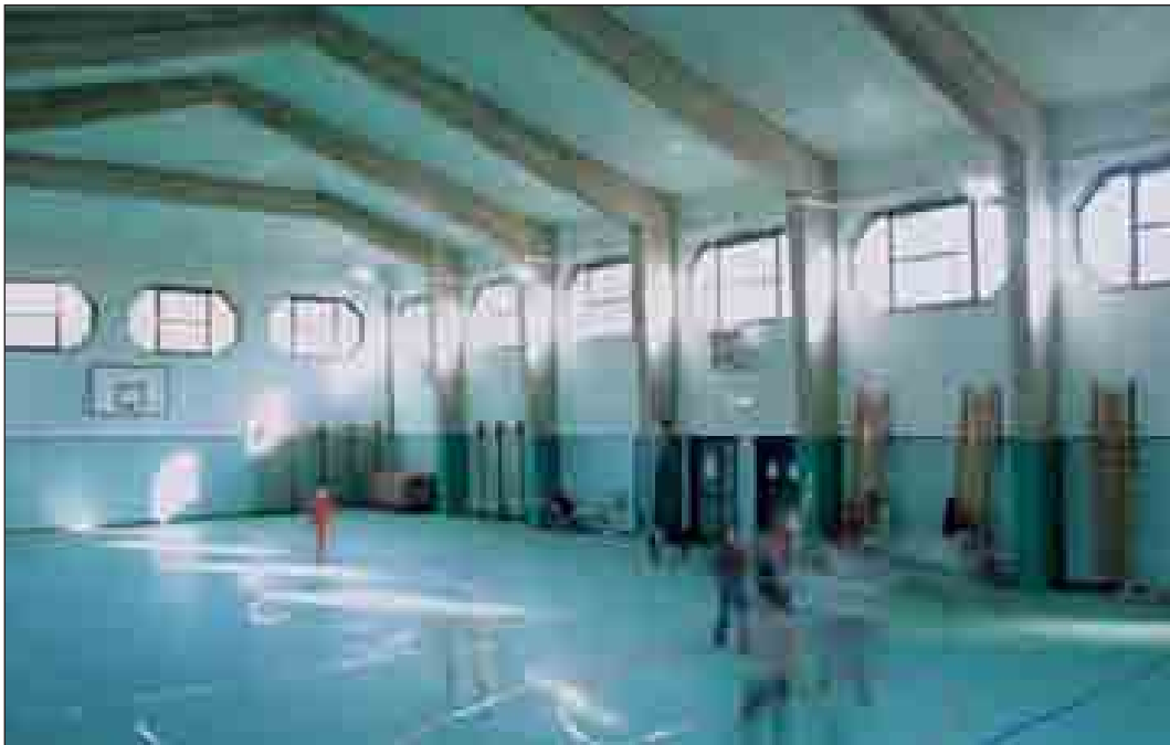
Palestra Castelli Calepio (BG) Rivestimento del soffitto e pareti realizzato con pannelli in sughero SoKoVerd.C1
