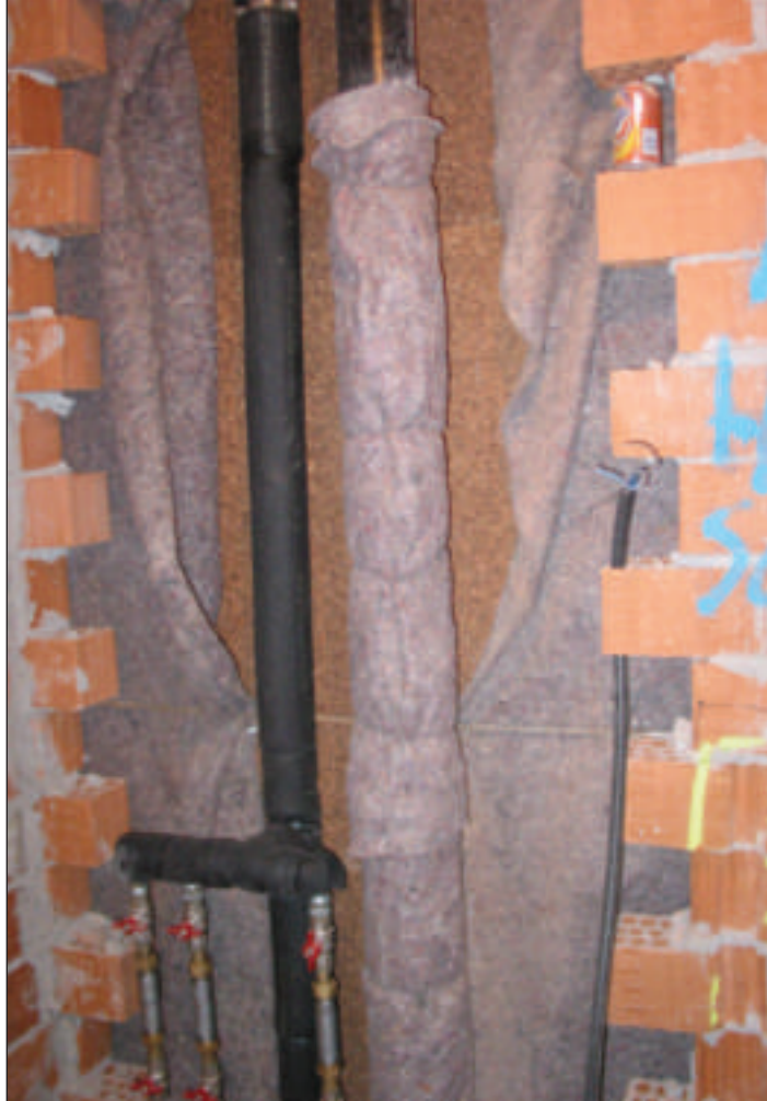
Particolare fasciatura degli impianti nel cavedio utilizzando ovatta vegetale KofIVeg e sottostante pannello in sughero bionado naturale SoKoVerd.AF
