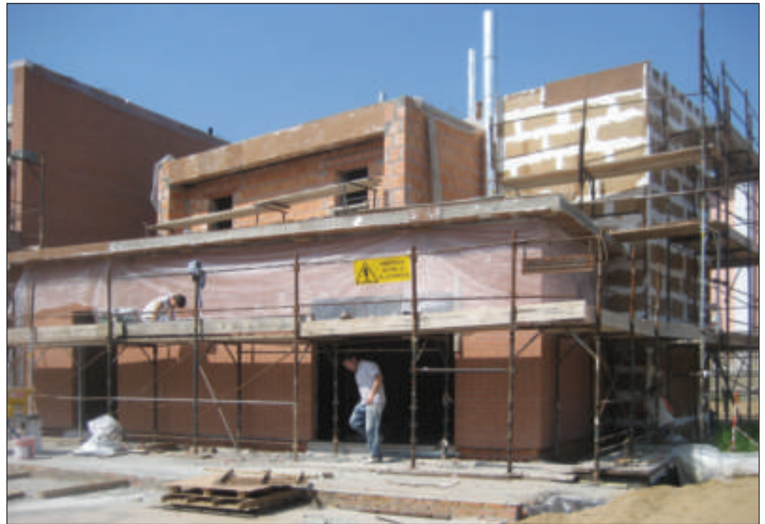
Edificio "Bioclimatic Sensitive Building", di proprietà Mariangela Magatti in Abbiategrasso (MI). Fase di realizzazione a cappotto esterno SoKoVerd.KE con ancoraggio pannelli in sughero biondo naturale superkompattato SoKoVerd.LV a grana fine 2/3mm mediante ancorante cementizio Prakov.
