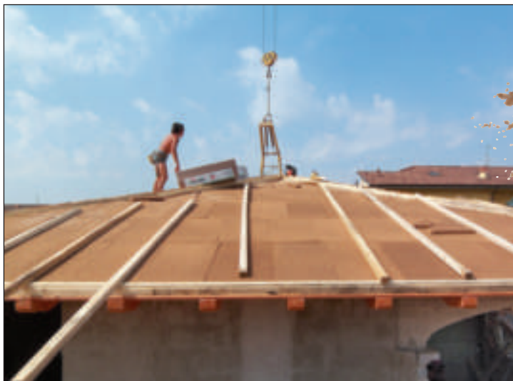
Tetto bioedile isolato con doppio strato di pannelli in sughero biondo naturale superkompatto SoKoVerd.LV a grana fine 2/3mm
