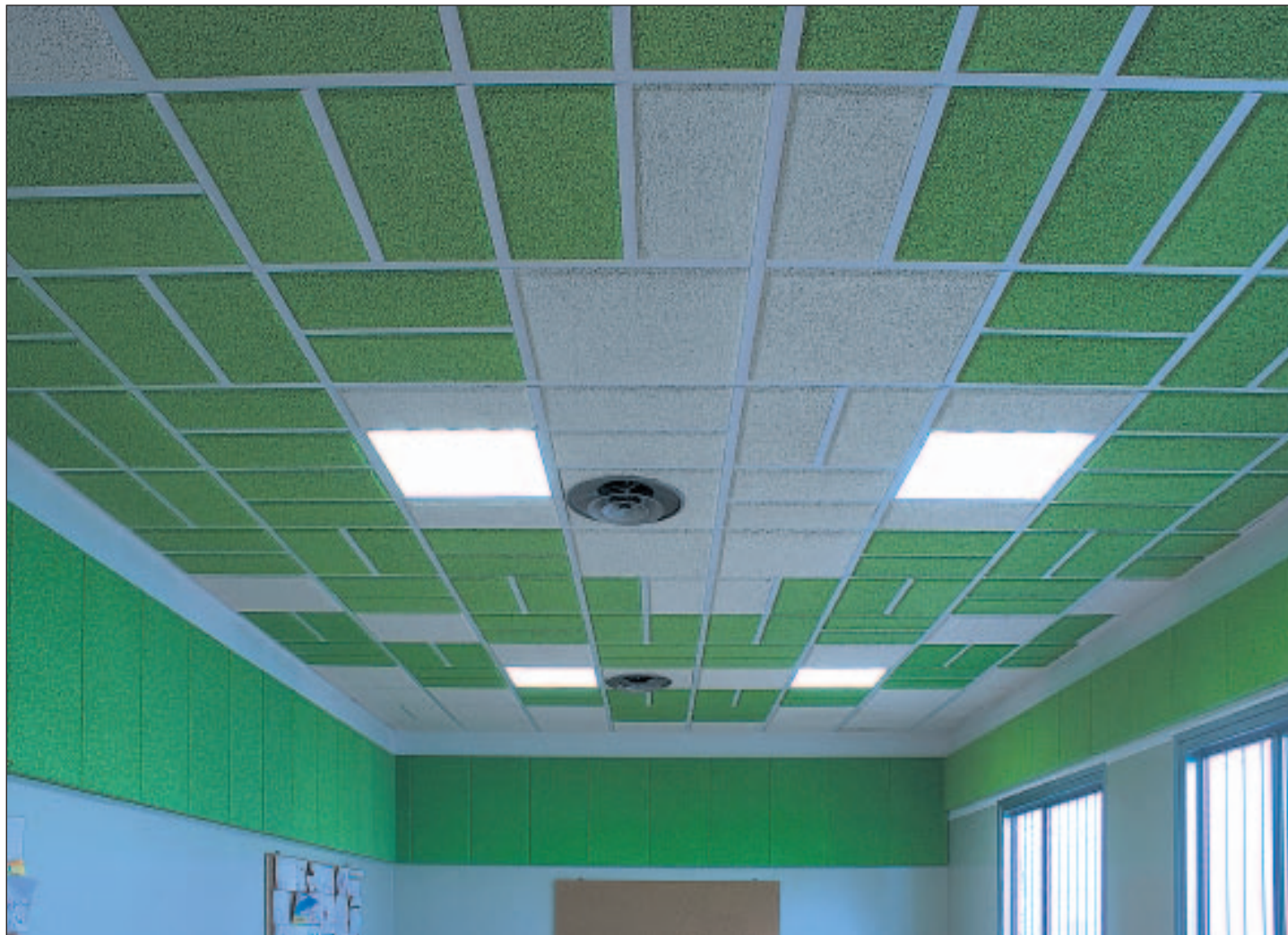
Mensa: il controsoffitto in sughero Kontro ed il rivestimento delle pareti in sughero SoKoVerd C1 hanno eliminato il "rimbombo" che causava stress nei bambini e insegnanti.
